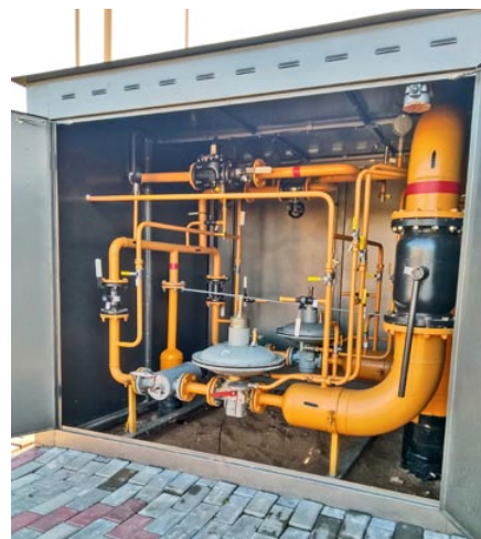
Напольное ШРП снаружи и внутри
