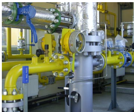
Узел установки подготовки топливного газа
