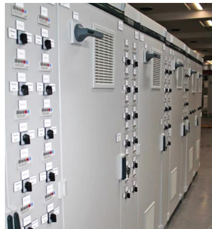
Силовые шкафы линий приготовления реагентов для ООО «ЕвроХим-Усольский калийный комбинат»
