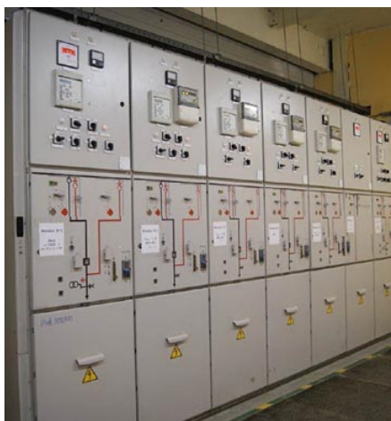
Высоковольтное распределительное устройство с элегазовыми ячейками
